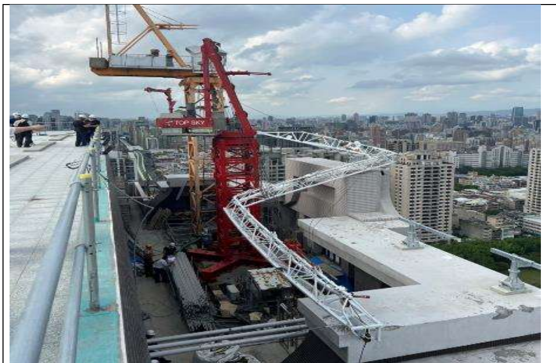
照片 2：拆除機伸臂掉落於建築物屋頂折彎情形。
